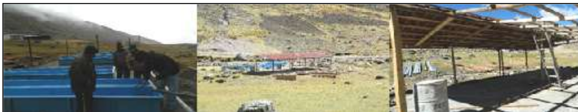
Figura 2: Avance de la construcción de módulo prefabricado realizados en la represa Pampacocha, por la comunidad
